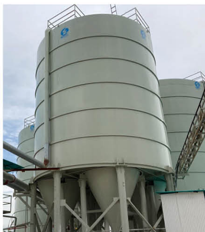
四川利弘陶瓷污水处理系统 Sichuan Lihong Ceramics Sewage Treatment System
