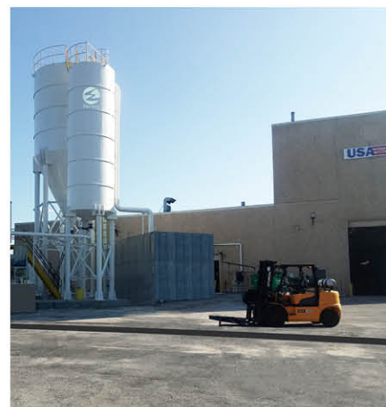
美国石英集团污水处理系统 Usa quartz co.,Ltd. Sewage Treatment System
