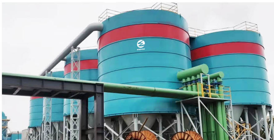
九江诺贝尔陶瓷污水处理系统 Jiujiang Nobel Ceramic Sewage Treatment System
